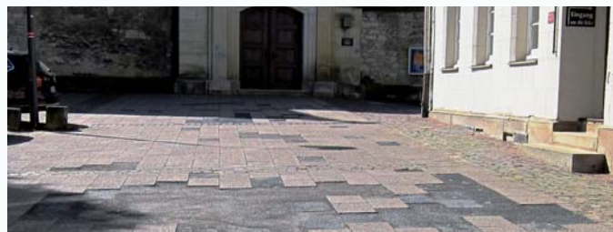
Dringender Handlungsbedarf: der Weg zum Rathaus und in die Kirche
